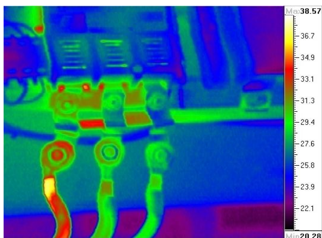
Рисунок 21. Пример термограммы контактных соединений с температурной шкалой
