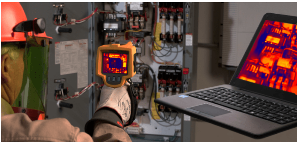
Рисунок 20. Пример проведения тепловизионного контроля электрошкафа
